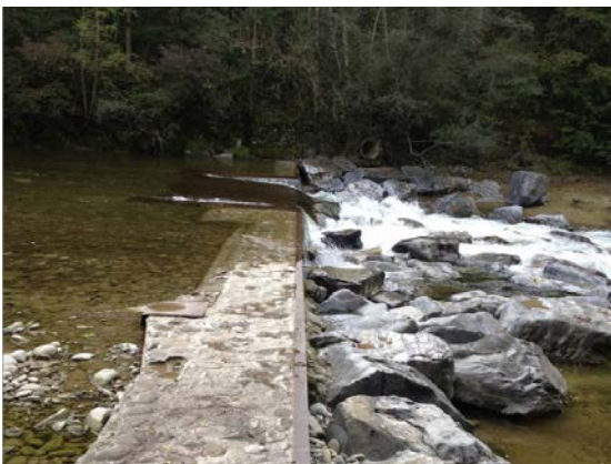
Schwelle bei der Hydrologischen Messstation des BAFU in Thörishaus (Foto: Pronat)
