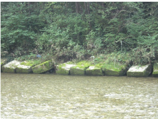
Unterspülte Betonquader im Bereich Noflenmatte. (Foto Flussbau AG SAH)
