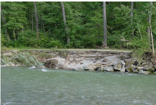
Zerfallener Uferschutz bei Ramsere. (Foto Flussbau AG SAH)
