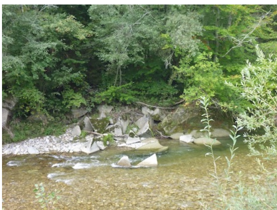
Beschädigter Uferschutz im Bereich Gäu / Büffel. (Foto Flussbau AG SAH)
